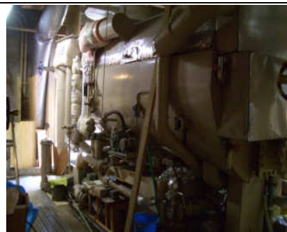
写真:新館1Fのボイラー設備
