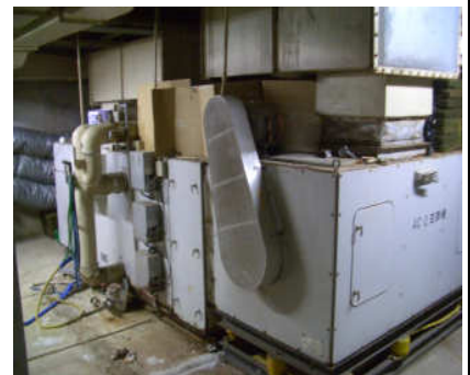
写真：本館地下のボイラー設備
