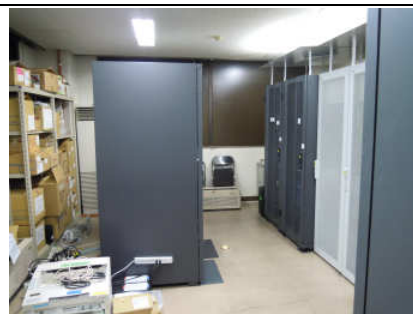
写真:コンピュータサーバ室
