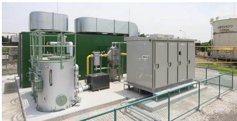
黒川消化ガス発電所
