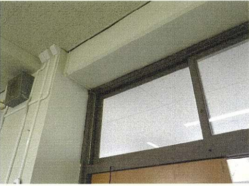
部位 職員室 窓枠・梁
