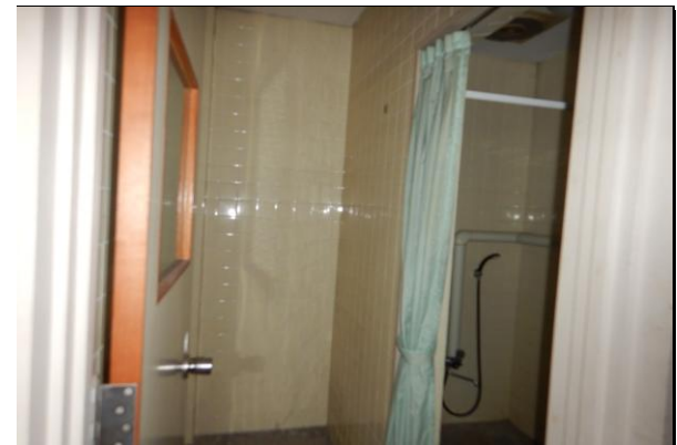
No.12 シャワー室
