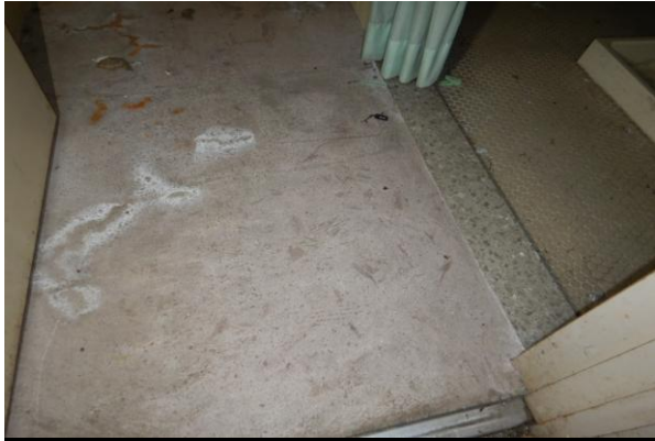
No.13 シャワー室
