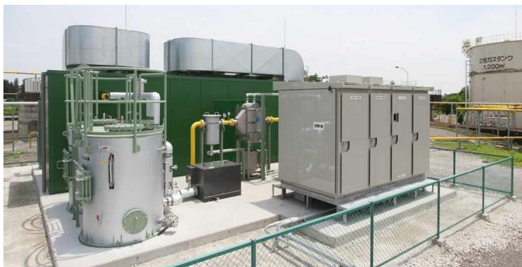
黒川消化ガス発電所
