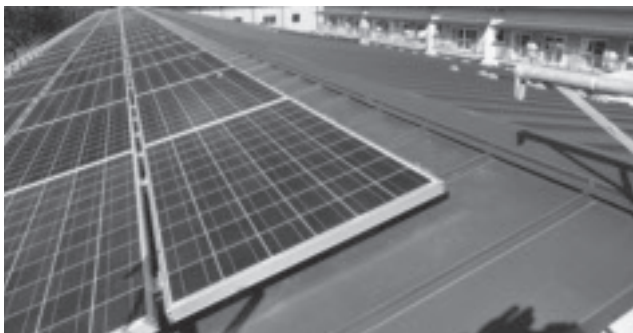
▲千寿荘の屋根に設置された発電設備
