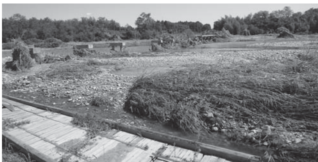
▲水害で流失した旧新田橋
