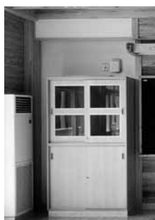
▲西中に設置されているエアコン
