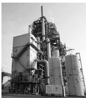
▲バイオマス発電所
