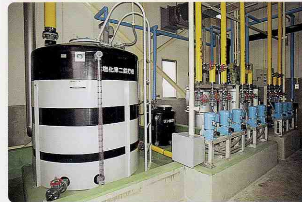
薬品注入設備
