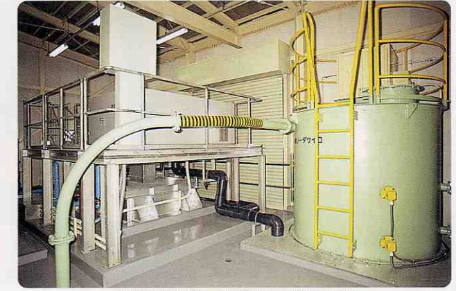
汚泥脱水機・炭酸ソーダサイロ
