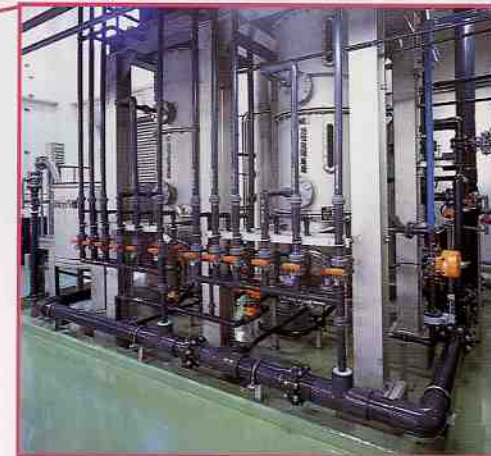
活性炭吸着塔
