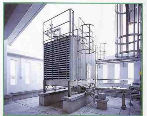
反応槽冷却装置
