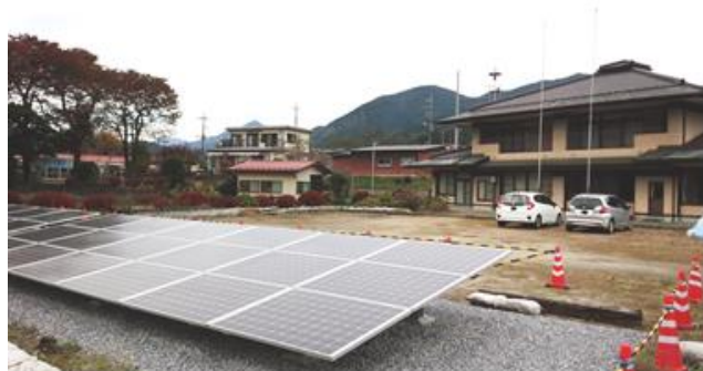
板荷コミュニティセンターの 太陽光発電設備
