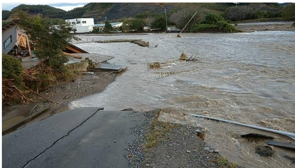
柳橋上流決壊箇所（口栗野）
