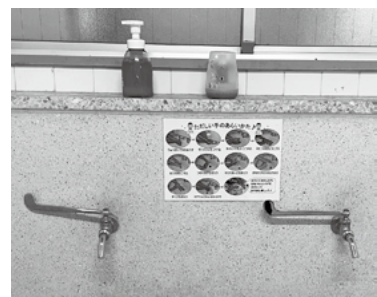
石川小学校の蛇口
