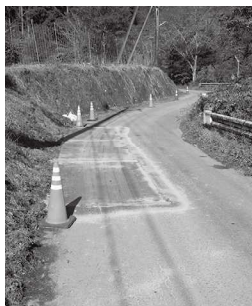
漏水と思われる工事箇所 (北村地区)
